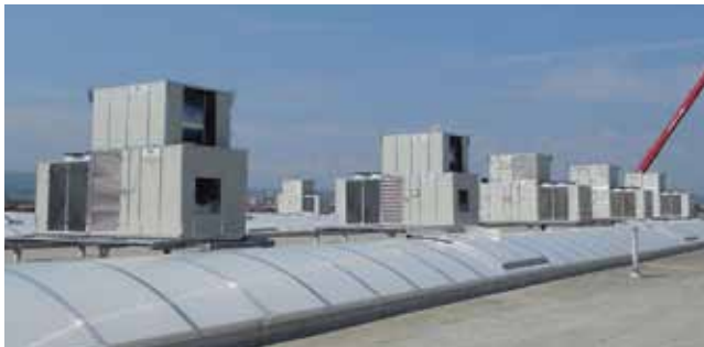
ROMANIA roof-top KRSAY 202 EM COMPACT
