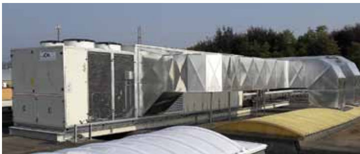
CANTÚ (Milano) roof-top KRSAY 202 EM H G
